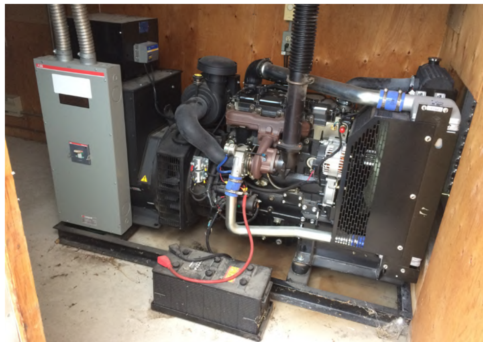
Groupe électrogène autonome de bonne dimension pouvant répondre aux exigences minimales d'une ferme en cas de mauvaises conditions météorologiques.
