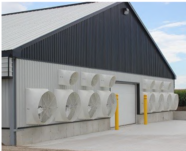
Ventilateurs longitudinaux installés dans le mur d'extrémité d'un poulailler de poulets à griller.
