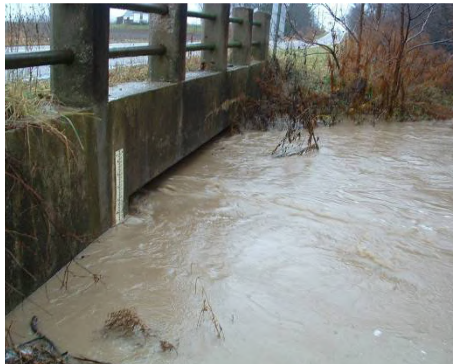
Des infrastructures de drainage construites, comme des ponceaux, devront peut-être être agrandies pour tenir compte des fortes précipitations actuelles et futures.
